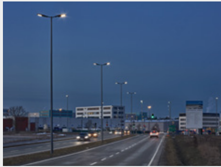
Luminarias para iluminación vial
